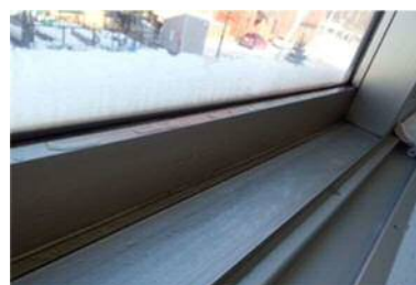
窓サッシの内側結露
